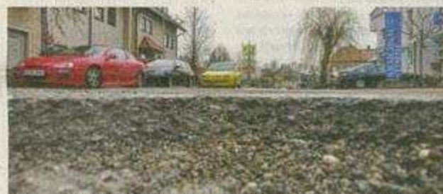
Dieses große Loch in der Mühlbacher Straße in Eppingen soll rasch geflickt werden. Die Stadt will das Budget für Straßenunterhaltung anheben. Foto: Alexander Hettich
