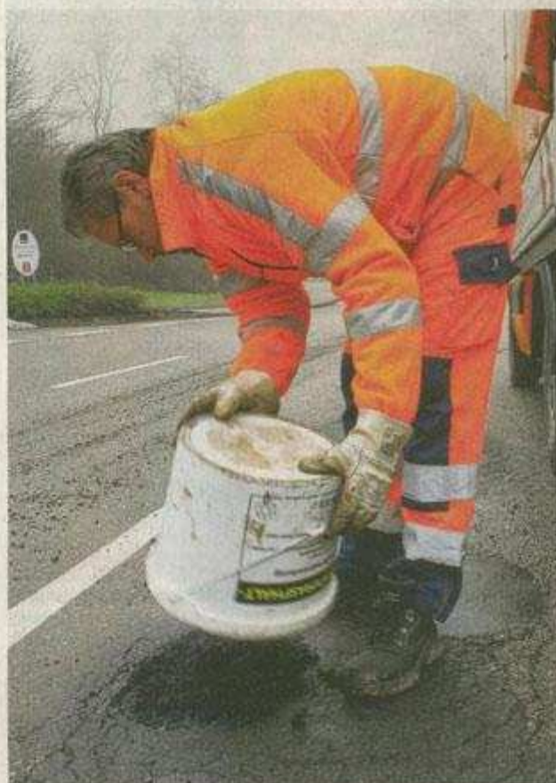
Der Kaltasphalt wird aus 25-Kilo-Eimern in das Schlagloch gegossen. Dieses Loch in Bad Wimpfen ist so groß, dass ein Eimer nicht ausreicht. Foto: Sara Furtwängler
