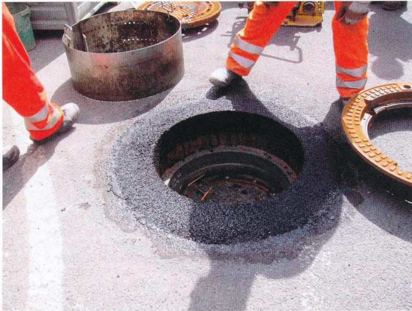
Abbildung 1: Perfekte Vorarbeit (Kaltasphalt) für das problemlose Einsetzen einer einwalzbaren Schachtabdeckung. Fotos: Beck
